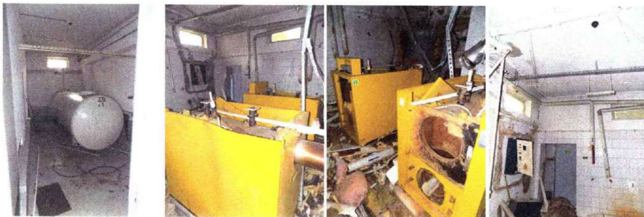
Widok kotłowni z kotłami olejowymi oraz pomieszczenia z zbiornikami na olej opałowy w podpiwniczeniu pawilonu wczasowego 3 kondygnacyjnego
